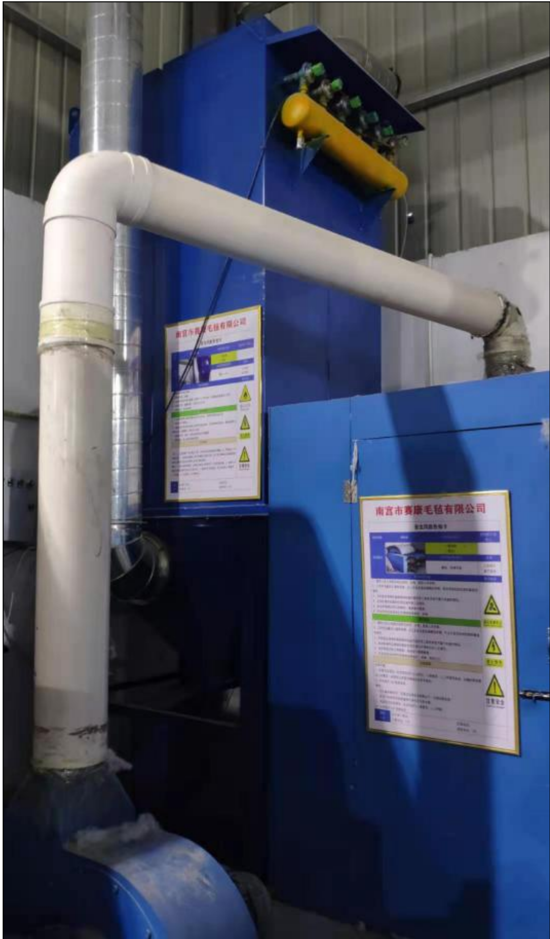
图 4-4 布袋除尘器装置
