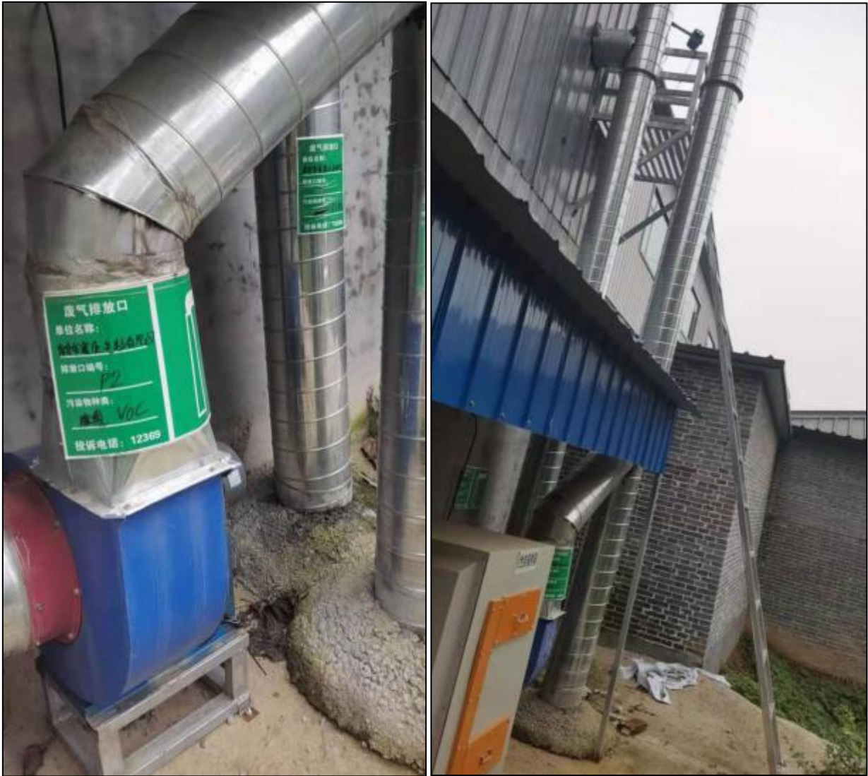
图 4-2 排气筒标识牌及废气监测平台
